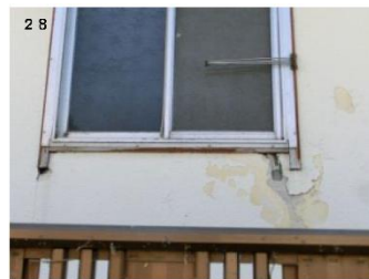
28 外壁にひび割れと剥離
