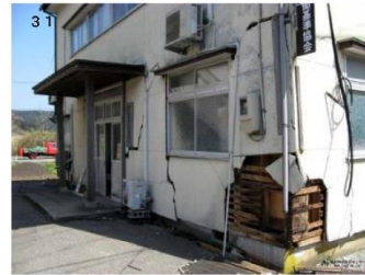
31 著しいひび割れ
