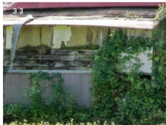
33 著しい劣化による壁剥落
