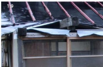
構造部材の大規模な損傷
