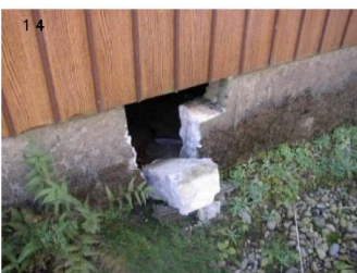
基礎に大規模な欠損
