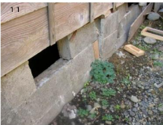
基礎に著しい損傷と傾斜
