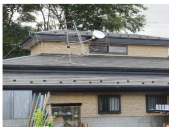
テレビアンテナの落下のおそれ
