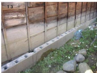
基礎と土台に大規模なずれ
