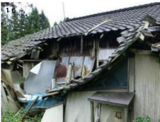
構造部材の大規模な損傷
