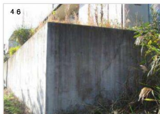
擁壁のひび割れ
