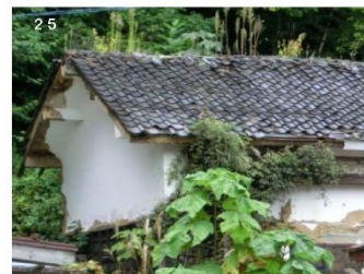
25 屋根の変形、樋や軒先の破損
