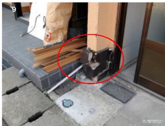
基礎の部分的な欠損
