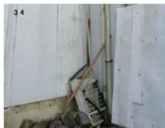
設備機器の落下（落下済み）
