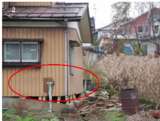
局所的な基礎の不同沈下
