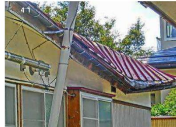
屋根の一部変形
