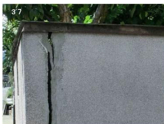
ひび割れが発生している (25 点)
