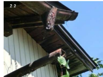
22 雨どいの破損・軒天材の腐食
