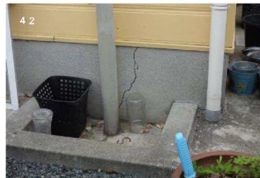
基礎のひび割れ
