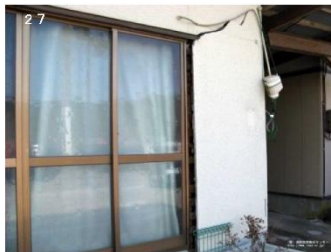
27 外壁にひび割れと剥離
