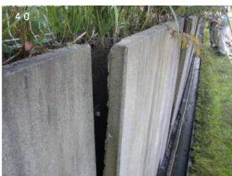
崩壊の恐れが高い
