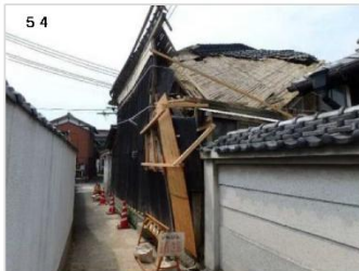
壁の著しい傾斜が見られる
