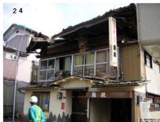
24 屋根が著しく破損している
