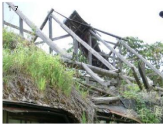
構造部材の大規模な損傷
