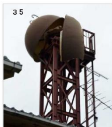
屋上の高架水槽に落下のおそれ
