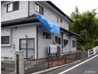
20 屋根ふき材の剥離
