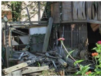
既に一部倒壊している
