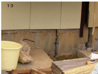
基礎に著しいひび割れ
