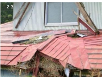
23 著しい変形と樋などの破損
