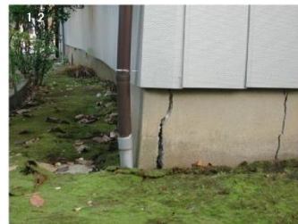
基礎の著しいひび割れ
