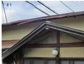
21 屋根ふき材の剥離
