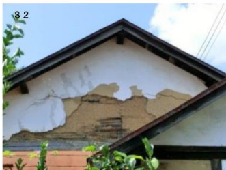
32 著しい劣化による壁下地の露出
