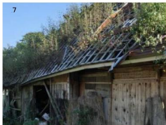
一見して倒壊のおそれがある
