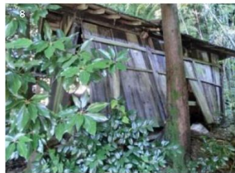
一見して倒壊のおそれがある
