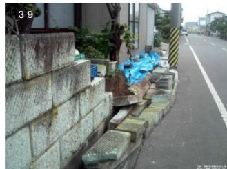
既に倒壊している (50 点)
