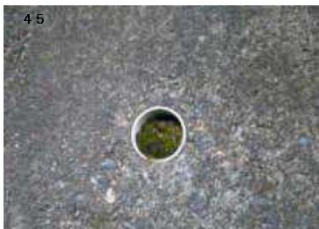
水抜き穴の清掃未実施
