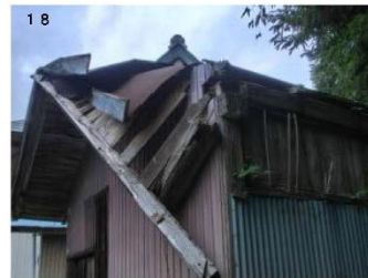
構造部材の大規模な損傷
