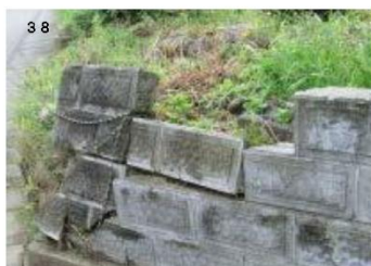
既に倒壊している (50 点)
