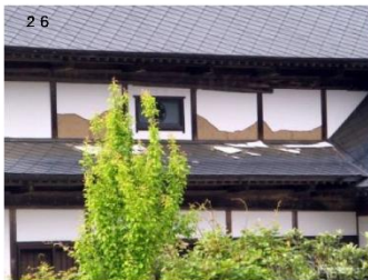
26 外壁仕上げの一部が剥落
