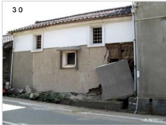
30 大規模なひび割れ及び剥落
