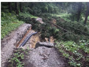
林道立川線被害
