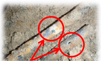
腐食による穴 ガス漏れで見つかりました
