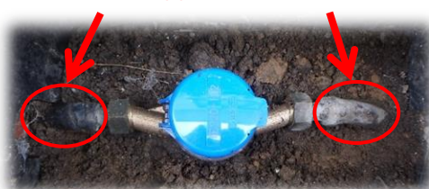
水道メーター
