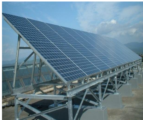
響ホールの太陽光発電
