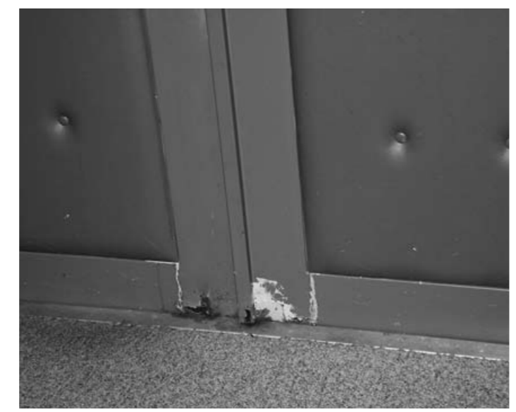
▲開かない非常口（第一公民館）
