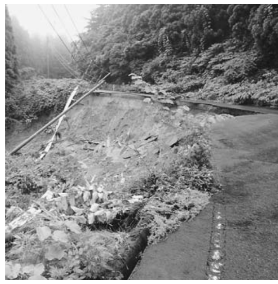
▲路肩決壊した町道肝煎添津線
