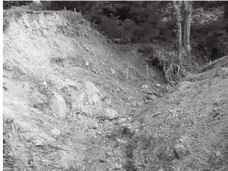
浸食された林道
