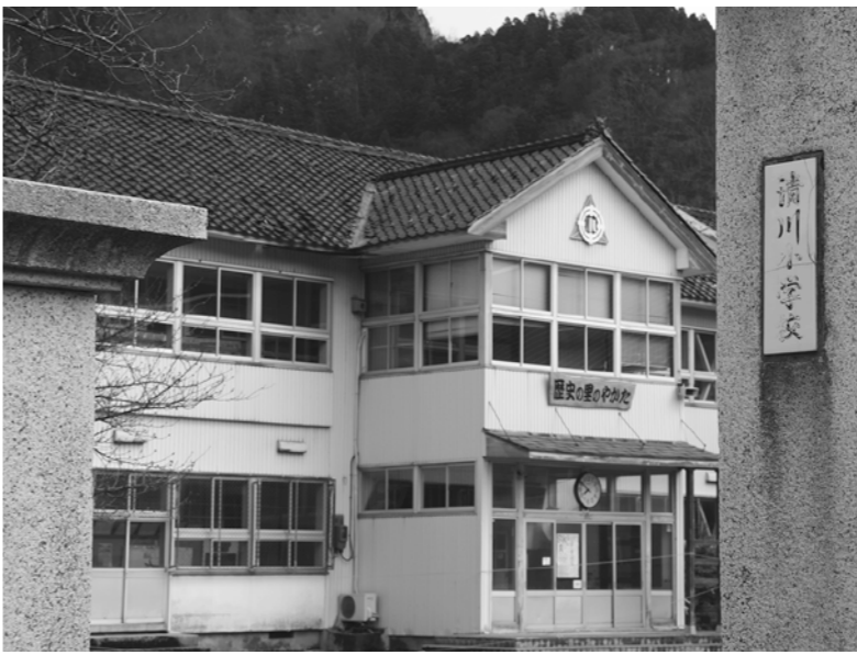
落瓦注意、早期解体が望まれる (旧清川小)
