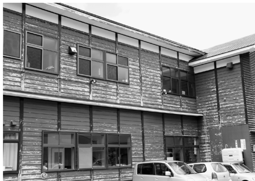
劣化した外壁 利用者もがっかり
