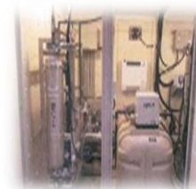
膜ろ過装置「木ノ沢配水池」
