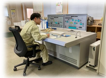
企業調庁舎内「中央監視装置」
