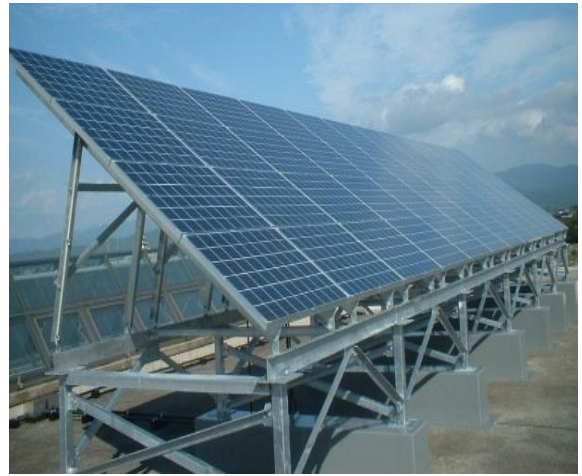
響ホールの太陽光発電
